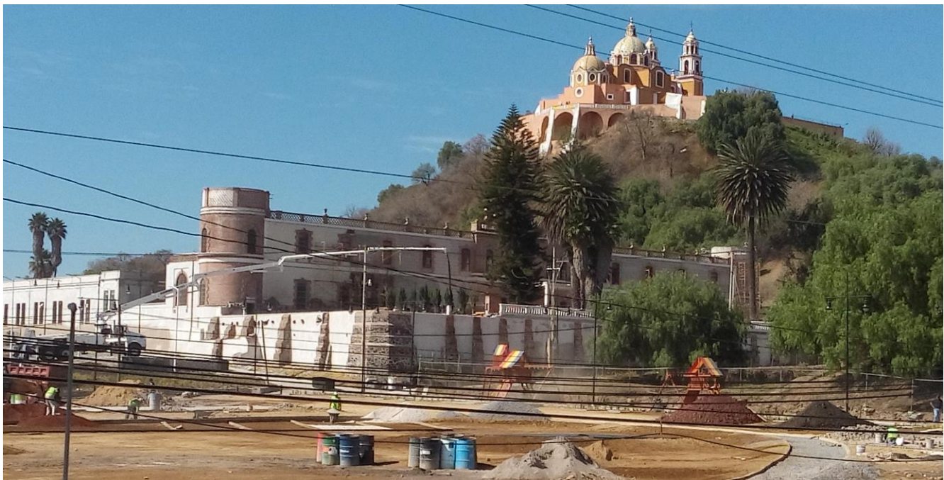
Figura 3. Obras del Parque Intermunicipal y Museo Regional de Cholula en proceso; vista norte. Foto: Cristina Desentis.
