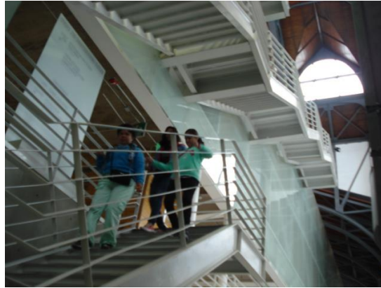
Figura 13. Escaleras que comunican sólo los niveles impares y carecen de conexión con niveles pares, lo que genera confusión en el usuario y complica su desplazamiento. (Solano, 2015)
