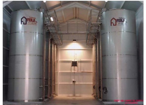
Imagen 30 - Tanque de producto terminado
