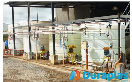
Imagen 28 - Tanque de Hidróxido de Sodio
