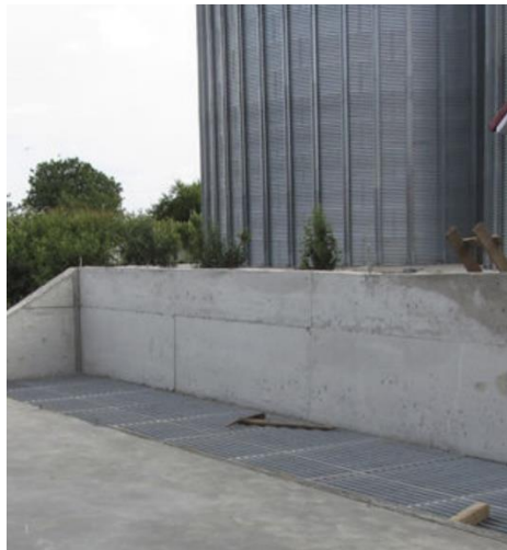
Imagen 31 - Tolva de recepción de materia prima
