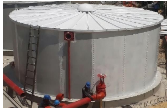
Imagen 32 - Tanque cisterna de agua
