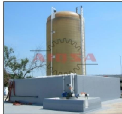
Imagen 29 - Tanque de Ácido Fosfórico
