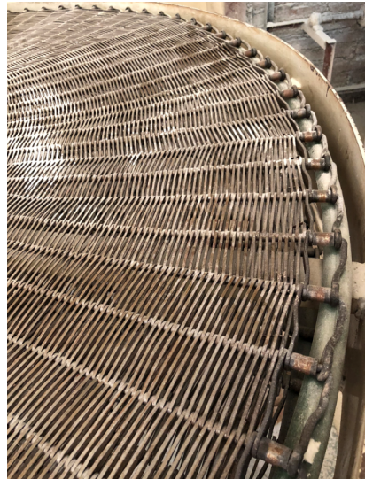
F 3.9 Cinta de enfriado Fuente: Foto Propia
