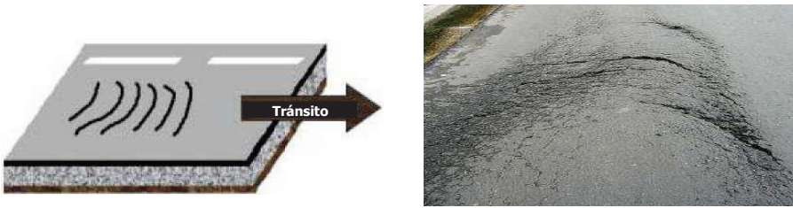
Figura 6 Falla del tipo fisuras en arco o media luna
