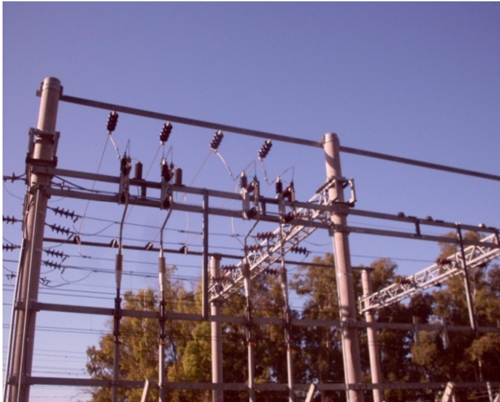
Fotos del PSA (Puesto de Seccionamiento Auxiliar) Villa Elisa, Línea Roca
