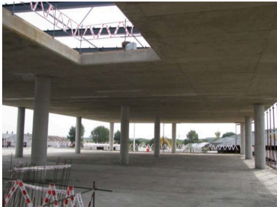
Figura 52: Vista inferior al desencofrar
