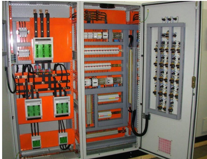
Figura 12-1: Tablero eléctrico. Fuente: Cantou Ingeniería - 2018
