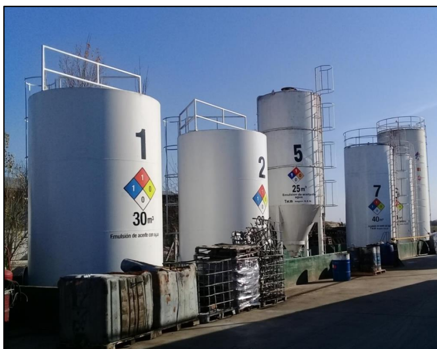
Figura 3.2: Tanques de almacenamiento con sus respectivas indicaciones de capacidad y cartel diamante.
