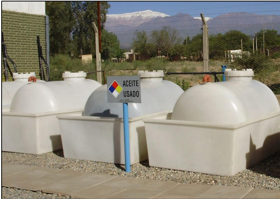
Figura 4.2: Cisternas plásticas incorporada en una batea con tapa para almacenamiento de aceite.
