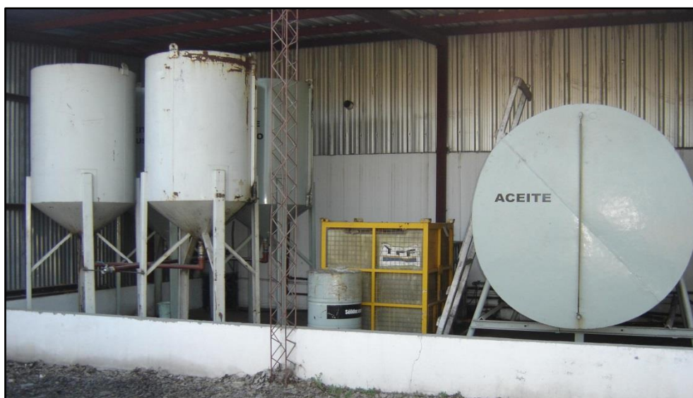
Figura 2.10: Cisternas de almacenamiento de aceite en desuso de un taller de transformadores eléctricos.
