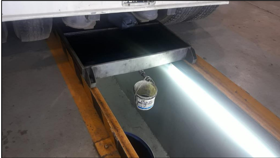
Figura 2.7: Sistema de recolección de aceites lubricante en la operación de recambio.
