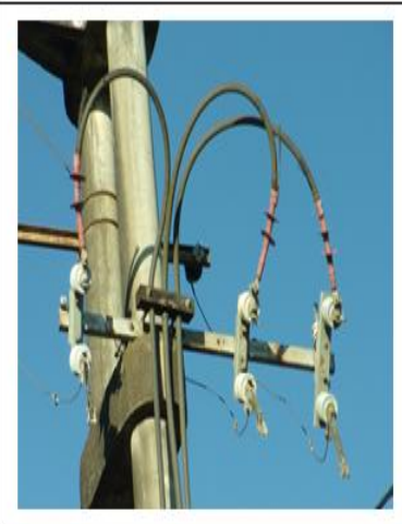
Fig.4 Seccionador Unipolar abierto
