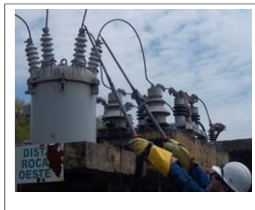
Fig. 8 Verificando ausencia de Reanclador
