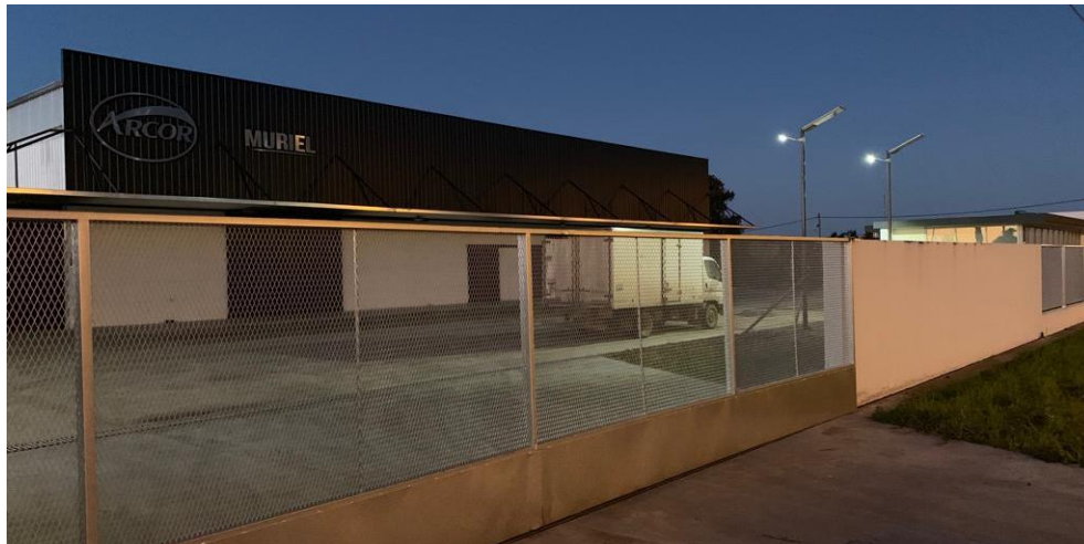
Fig. 3. Ejemplo de implementación de dos luminarias solares con panel solar separado
