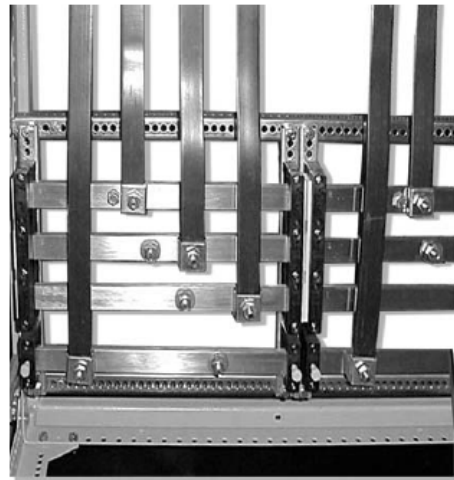
Gabinete Nöllek con dos buses de barras HD54310
