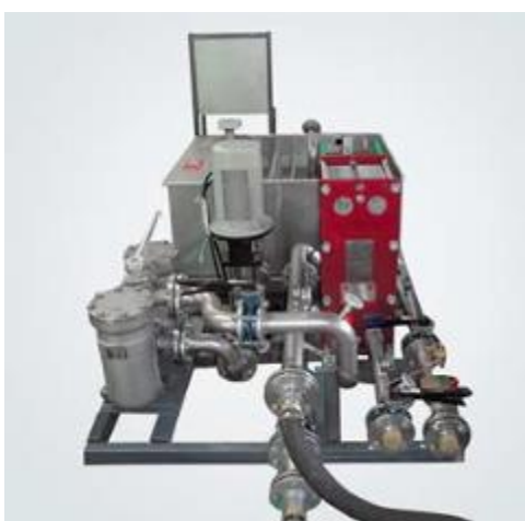
Figura N° 46: Sistema de recuperación de agua.
