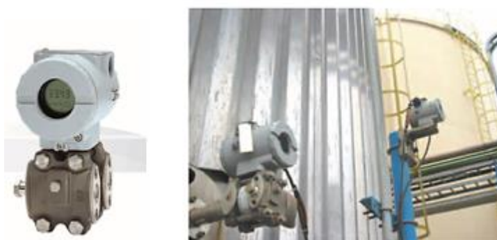
Figura N° 6: Transmisor de nivel LT-006 y su ubicación en el equipo.
