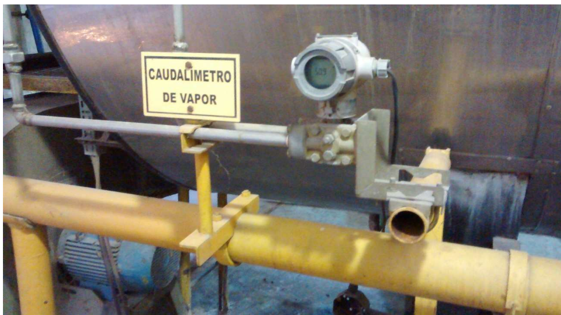
Figura 4 Caudalimetro de Vapor
