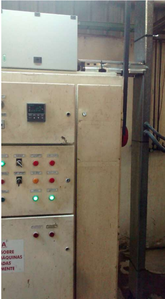
Figura 5 Ubicación sobre tablero general
