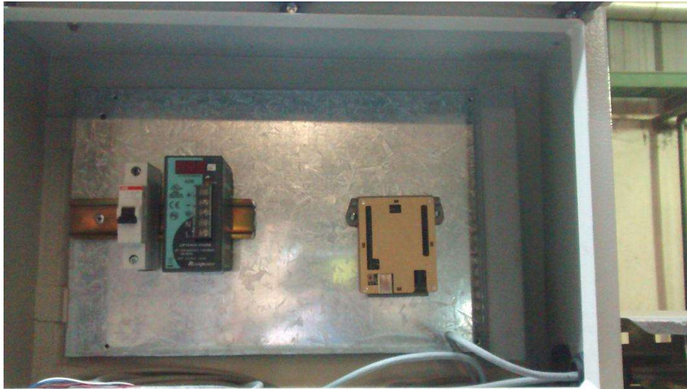
Figura 8 Interior de tablero - Arduino montado
