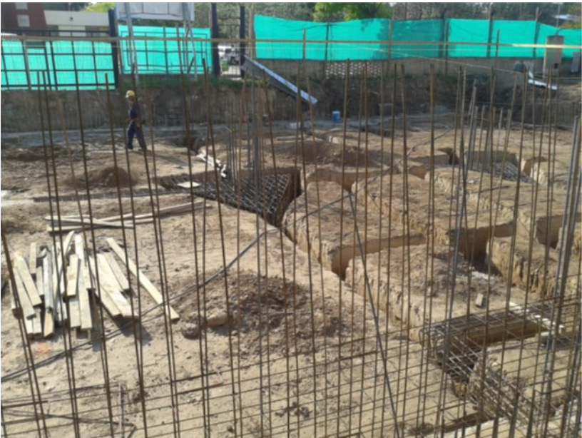
Figura 39.4: Fotografías de armadura de cabezal triangular para grupo de tres pilotes. Planta de cimentación. Edificio de la carrera de ingeniería civil, UTN FRC (octubre, 2016)
