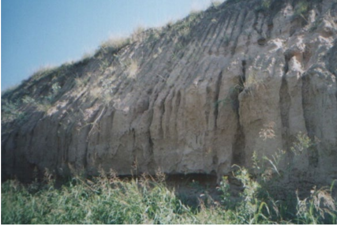
Figura 40.4: Daños importantes de erosión en un canal abierto sobre suelo limoso ( loess ) sin revestimiento y sin defensa
