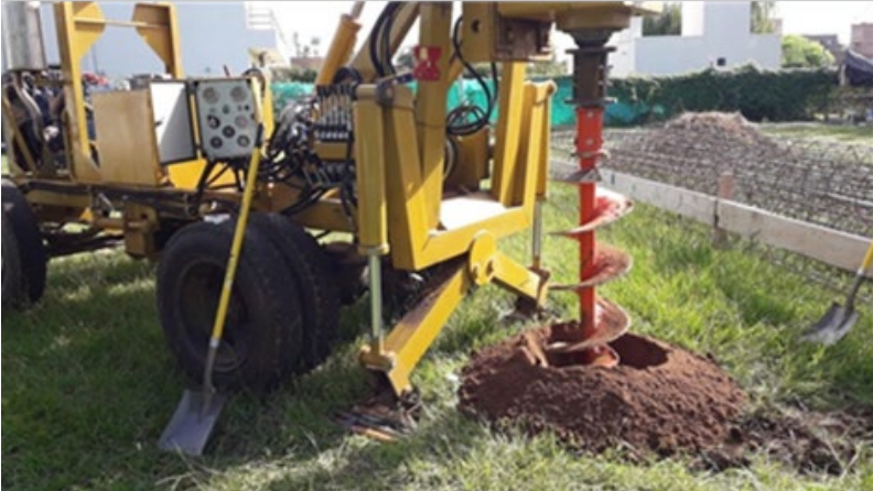
Figura 35.2: Excavadora de pilotes. Excavación de primer tramo ( GEF: Consultoría en Geotecnia, Estructuras y Fundaciones )
