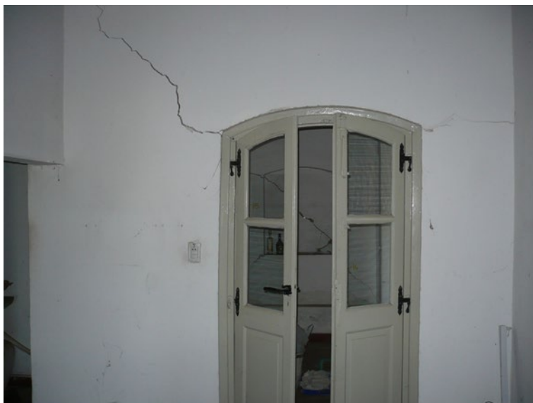
Figura 40.1: Fisuras en mampostería portante de una vivienda familiar cimentada con bases superficiales sobre suelos limosos “colapsables”
