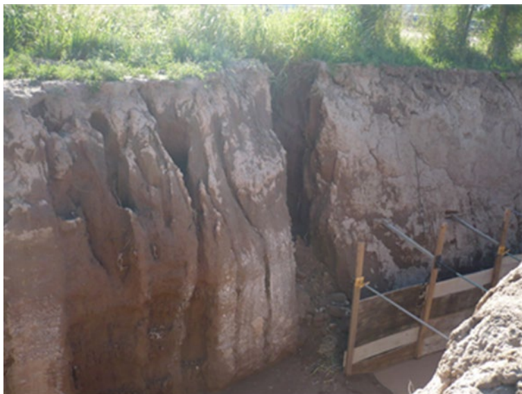
Figura 40.2: Daños moderados de erosión, deterioro y deslizamientos parciales en una excavación sobre suelo limoso "loess"
