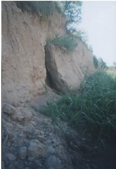
Figura 40.5: Deslizamientos parciales en bloque en un canal abierto sobre suelo limoso ( loess ) sin revestimiento y sin defensa
