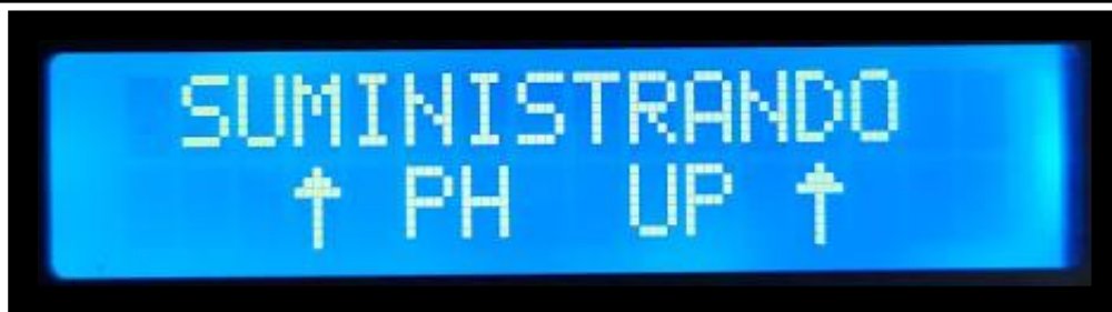
Figura N° 62: Pantalla mientras suministra Hipoclorito de Sodio.
