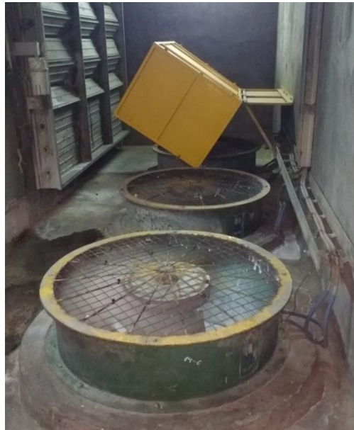
Imagen 6, viste a nivel del suelo de los ventiladores de retorno. A la izquierda se aprecia la persiana que da ingreso a la sala de pileta donde se mezcla con aire exterior.
