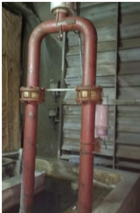
Imagen 8, vista del conducto de agua fría que abastece a la pileta, y de las válvulas de control de temperatura.
