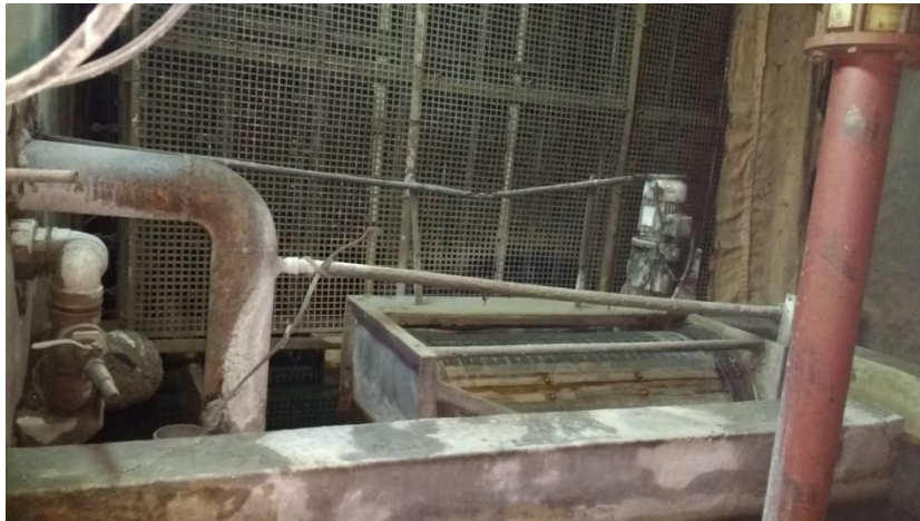
Imagen 9, a la izquierda se aprecia el conducto que abastece a la pileta, sobre el lado izquierdo la válvula tipo flotante de agua de red.
