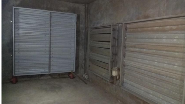
Imagen 13, vista interior de una de las cámaras de la segunda mezcla de aire. A la derecha persianas de aire de retorno, a la izquierda de aire saturado.
