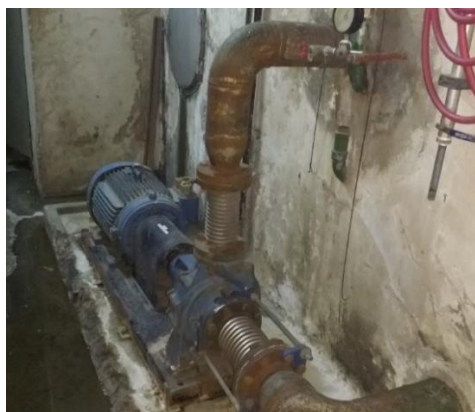
Imagen 10, bomba centrífuga para los rociadores.
