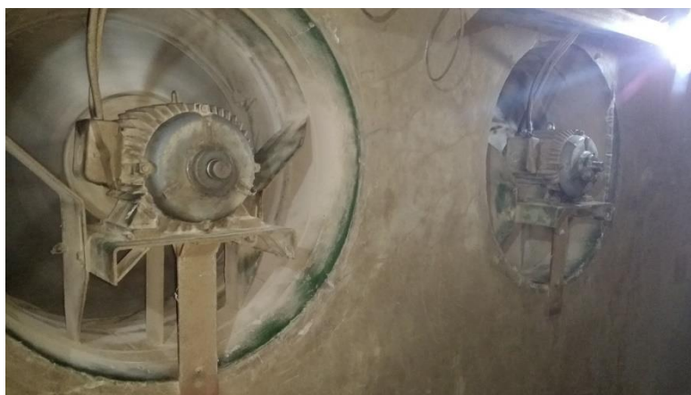
Imagen 14 ventiladores de inyección que envían el caudal de aire desde la sala de mezcla anterior al interior del establecimiento.
