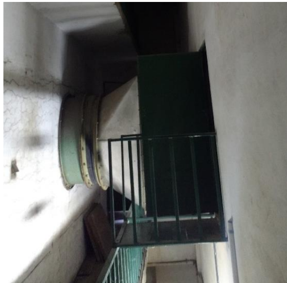
Imagen 15, vista de los conductos de inyección desde la sala de servicios.
