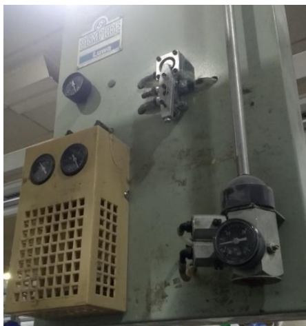
Imagen 16, tablero de operación
