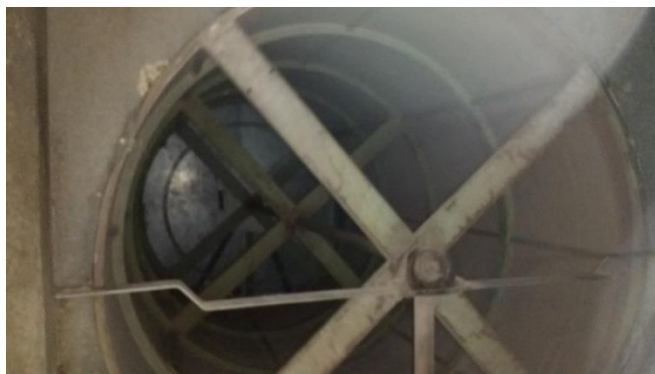
Imagen 4, vista interna del filtro rotativo desde la habitación siguiente, en el subsuelo.
