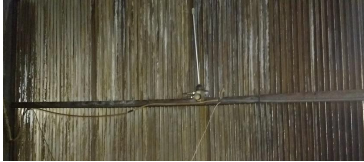
Imagen 11, Sensor de temperatura de saturación junto al panel separador de gotas.
