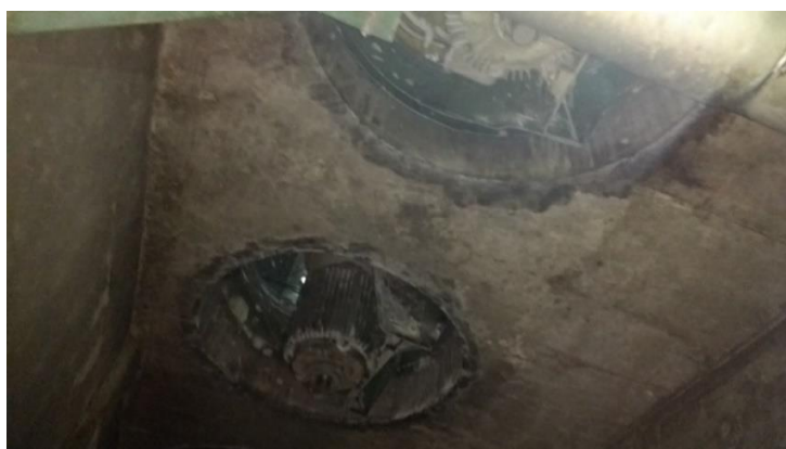
Imagen 5, vista desde el subsuelo hacia los ventiladores de aire de retorno
