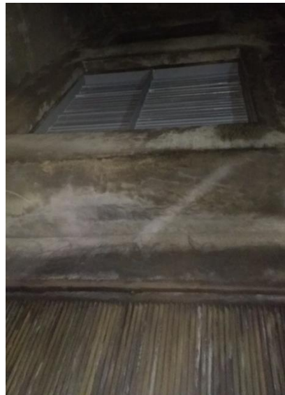
Imagen 12, túnel vertical de aire saturado de humedad. Se aprecian en los niveles superiores persianas de ingreso de aire saturado a la segunda etapa de mezcla.
