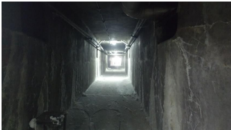
Imagen 1, vista de uno de los túneles de aspiración de aire retorno en el subsuelo de la planta
