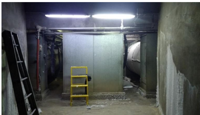
Imagen 3, vista de los tres filtros rotativos de aire de retorno
