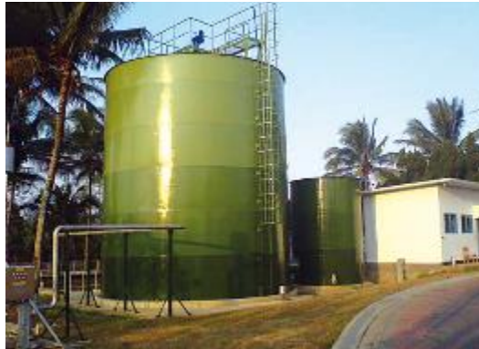
Ilustración 4.3.5.3.1. Reactor Biobulk CSTR
