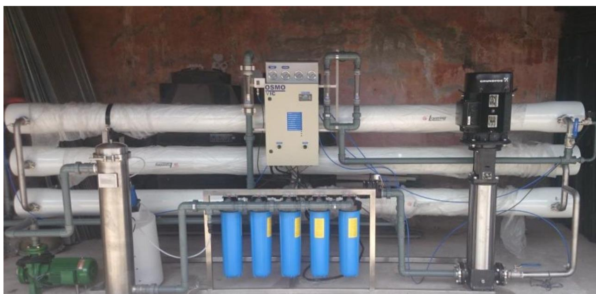
Imagen 10.16. Sistema de ósmosis inversa.
