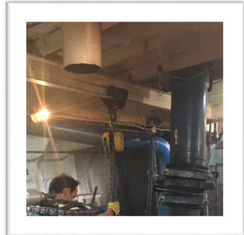
8 Aparejo para izar en sala de máquinas
