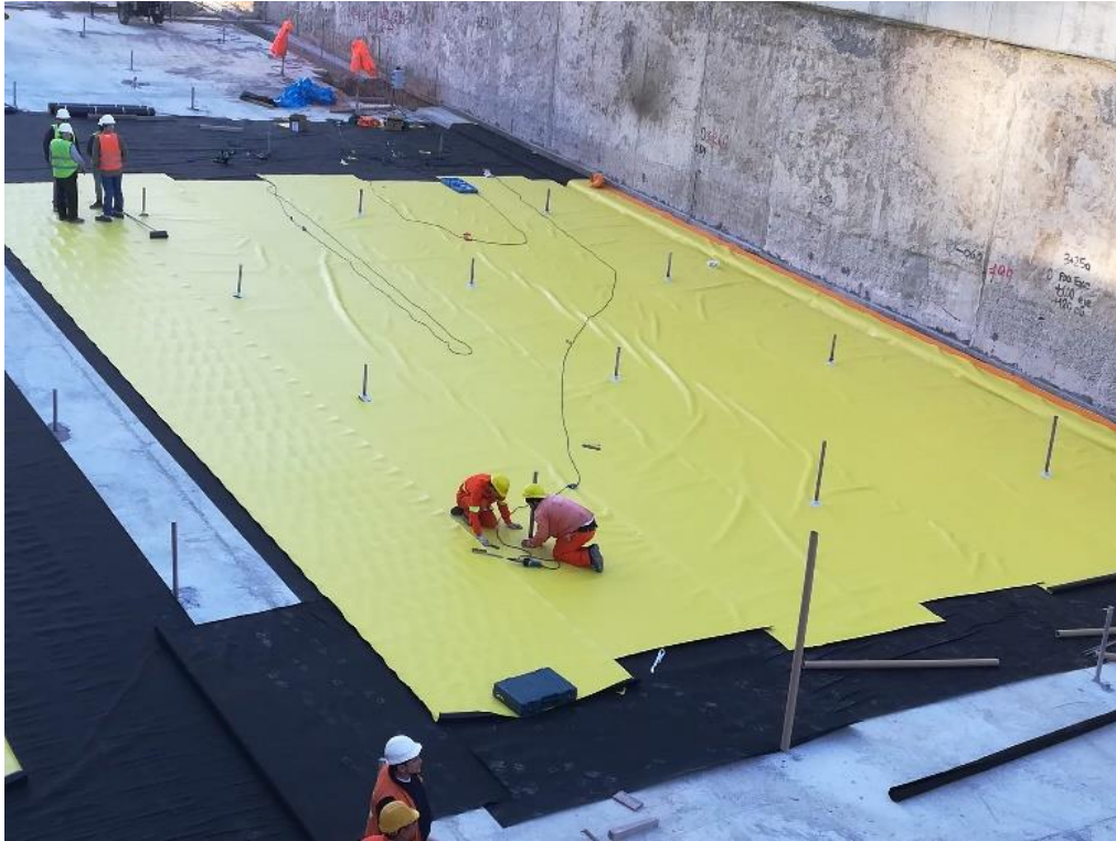
Figura 6-21: Imagen de la membrana de PVC bajo la losa de subpresión
