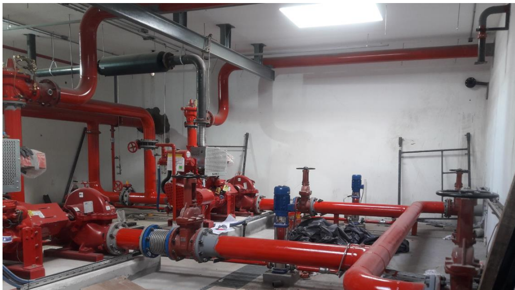
Figura 6-36: Sala de bombas del Paseo del Bajo
