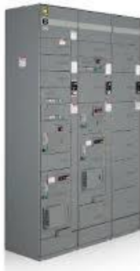
Figura 54. CCM Schneider Electric Modelo 6 Resistente al Arco. Fuente: Schneider Electric.
