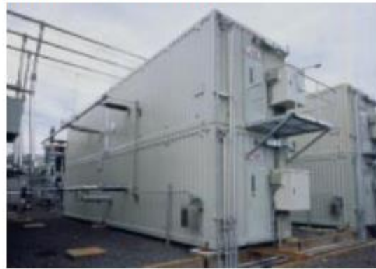
MÓDULO DE VÁLVULAS
