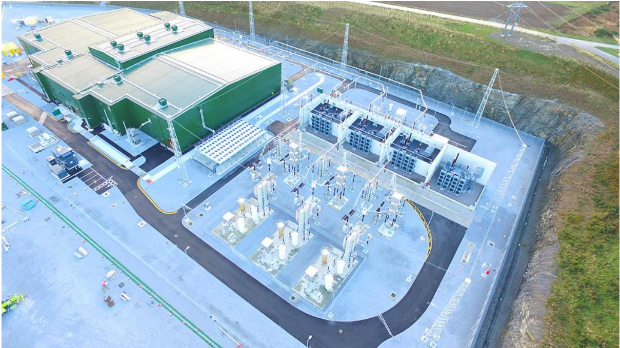
(Fig. 9-5) Estación Convertora HVDC VSC
