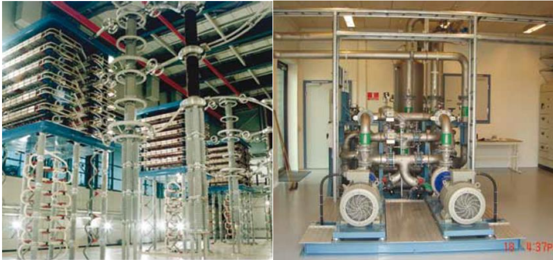
(Fig. 18-3) Sistema de refrigeración – Nelson River HVDC
