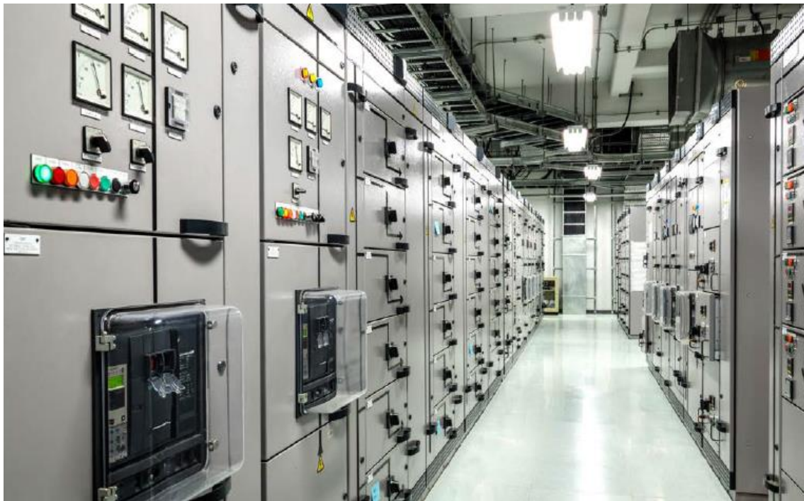
(Fig. 1-5) Sala de interruptores Conversor HVDC
