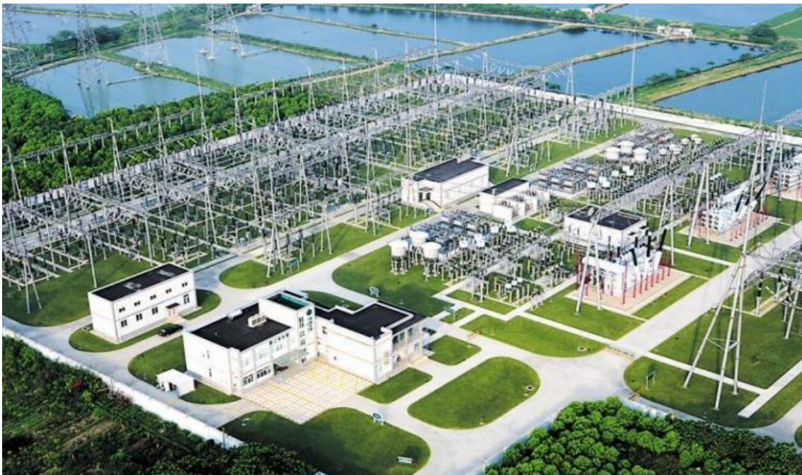
(Fig. 9-4) Jinping - Sunan, China LCC 800 kV - 7200 MW - 2093 km - Año 2012
