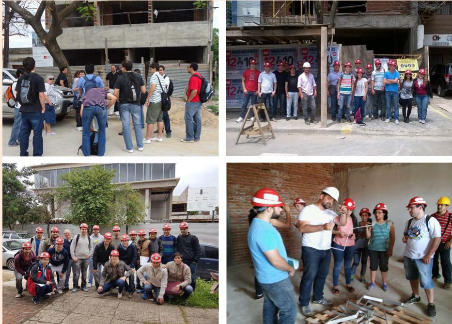
Fig. 14. Fotografías de visitas de obra con acompañamiento docente. Abajo a la derecha, se observa la situación de enseñanza en la propia práctica donde el docente muestra a los alumnos características de los materiales in situ .
