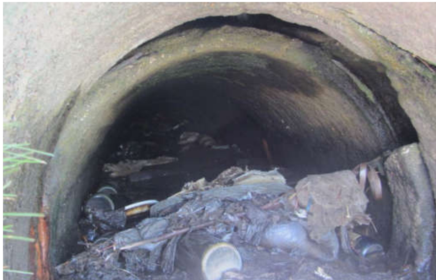
Ilustración 16 Desagüe pluvial obstruido por basura
