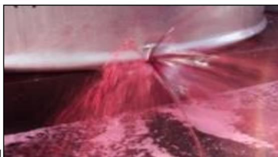
Figura 2 Tanque dañado por el terremoto de Maule, Chile en 2010 [9].
