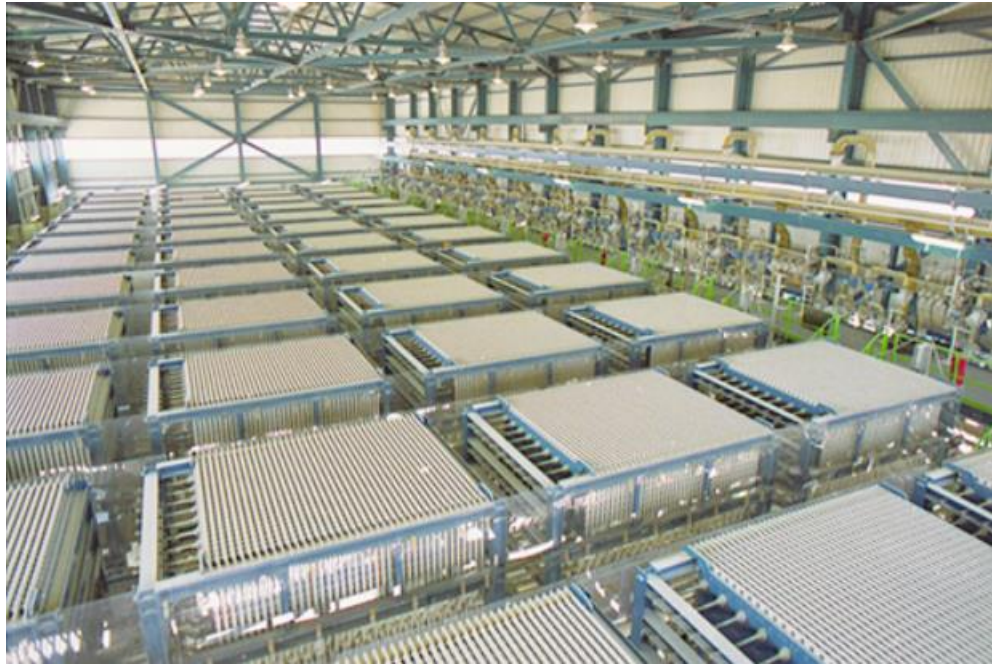
Imagen real celdas de obtención de cloro mediante proceso en celdas de membrana. Tomado de http://www.sapiensman.com/tecnoficio/electricidad/electrolisis_y_cloro.php
