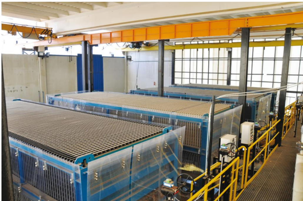
Imagen real de planta de producción de cloro con celdas de membrana. Tomado de http://www.transclor.com.ar/
