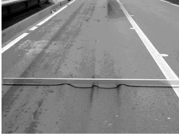
Figura II.6: Ahuellamiento en pavimento flexible. Fuente: elaboración propia, 2019.
