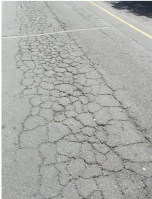
Figura II.5: Piel de cocodrilo en pavimento flexible. Fuente: elaboración propia, 2019.
