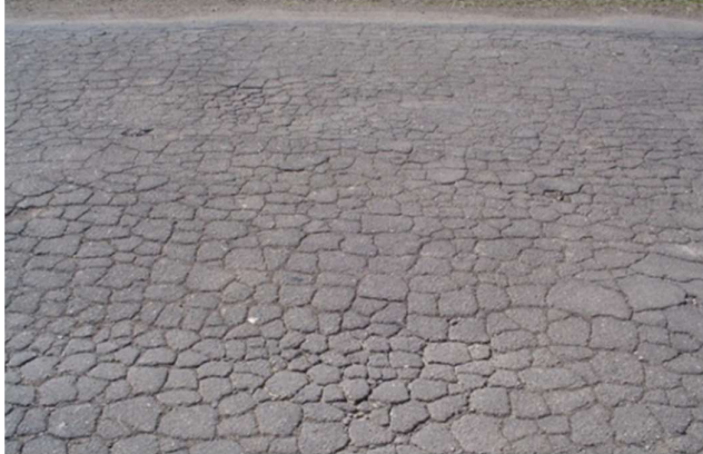
Figura IV.2: Patología piel de cocodrilo. Fuente: elaboración propia, 2018.
