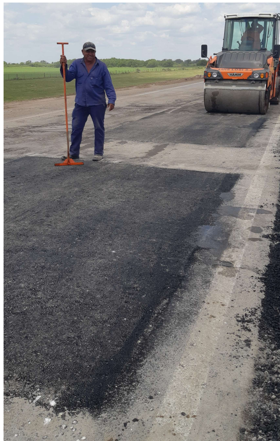
Figura II.8: Parche por reparación de bache en pavimento. Fuente: elaboración propia, 2019.
