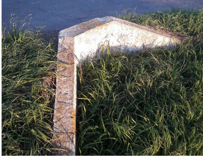
Figura IV.4: Alcantarilla obstruida. Fuente: elaboración propia, 2018.
