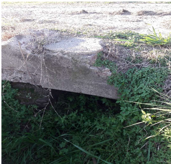
Figura IV.5: Alcantarilla con sección reducida por vegetación. Fuente: elaboración propia, 2018
