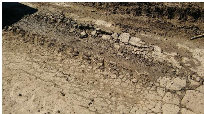
Figura IV.3: Bache en calzada. Fuente: elaboración propia, 2018.
