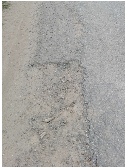
Figura II.9: Pérdida de la totalidad de la capa asfáltica. Fuente: elaboración propia, 2019.
