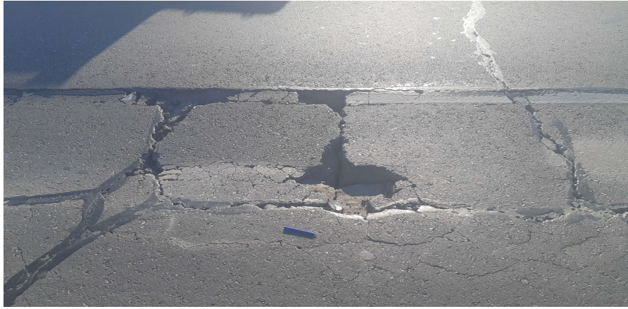
Figura II.7: Bache en pavimento flexible. Fuente: elaboración propia, 2019.
