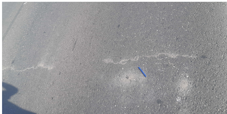
Figura II.4: Fisuración en pavimento flexible. Fuente: elaboración propia, 2019.
