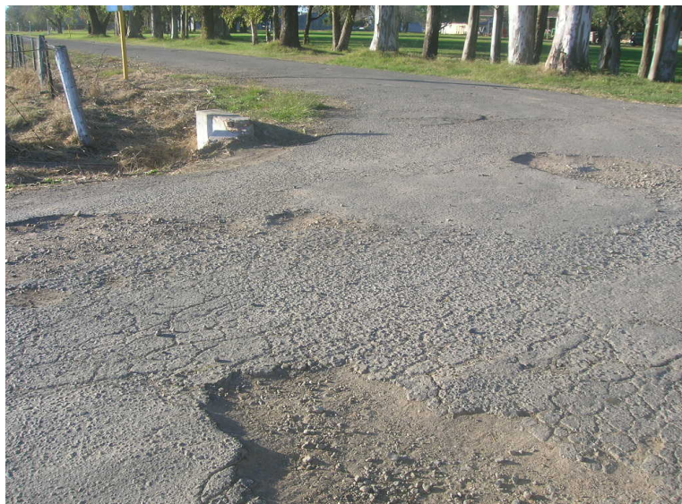
Figura I.2: Estado de caminos al momento de la solicitud. Fuente: INTA, 2018.
