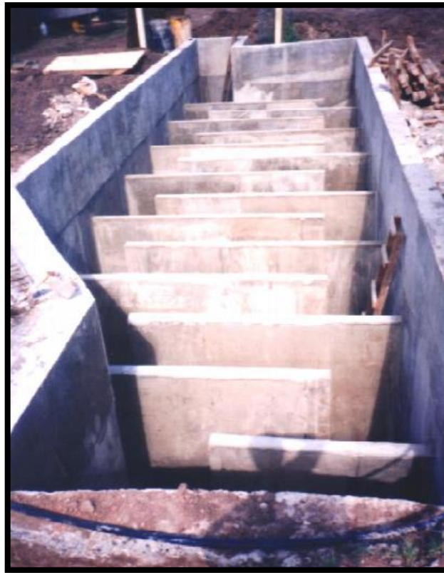
Figura 8.2. Cámara rompe cargas existente. Fuente: Cooperativa Telefónica de Tostado, 2003.
