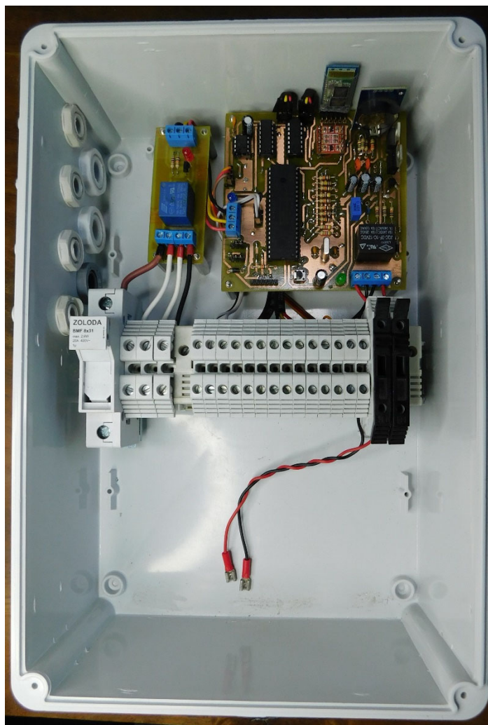
Fig. 48. PCB de control y potencia en gabinete con bornera para campo y portafusibles
