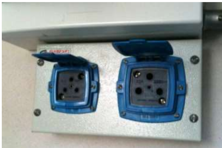
Figura 13.2: Toma corriente trifásico
