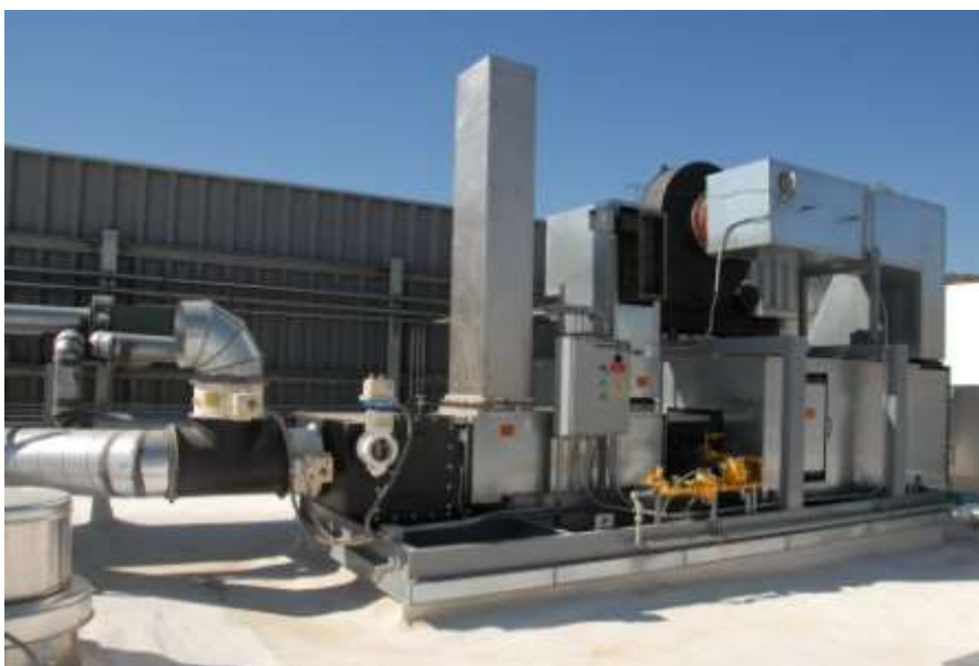
Figura 11.1: Incinerador F-211 adoptado para el tratamiento del gas residual
