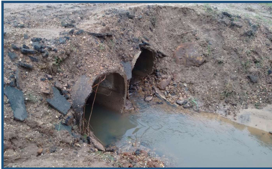
Imagen 10 y 11. Estado de las alcantarillas y del arroyo.
