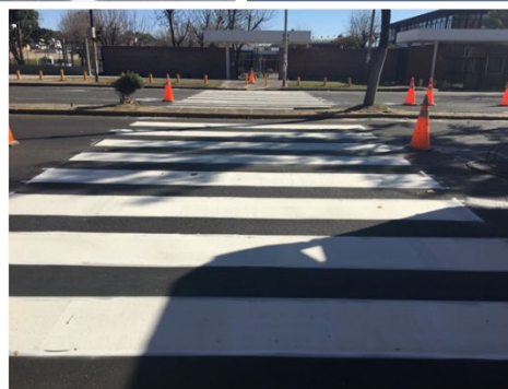
Figura 5-9. Aplicación de la Pintura A3 sobre la senda peatonal mano a Berisso
