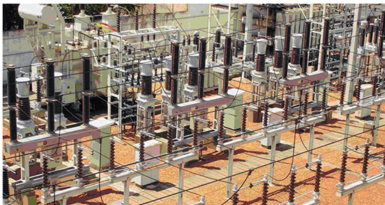
Fig 1. Estación transformadora de alta tensión
