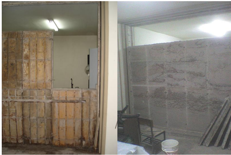
Figura 4. Vista del proceso de construcción del material bajo estudio N° 1: Tabique de cemento con agregado de pomeca puzolánica
