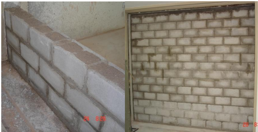
Figura 7. Vista del proceso de construcción del material bajo estudio N° 2: los bloques se rellenan con arena a medida que se van colocando las hiladas.
