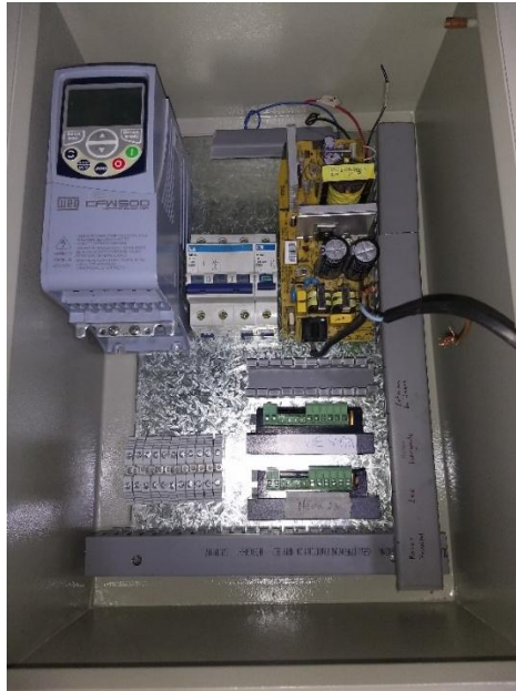
Figura 62: Disposición de componentes en el tablero.
