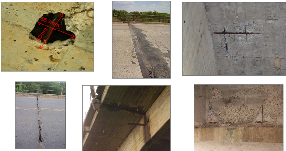
Figura 3: Diferentes afectaciones observadas.
