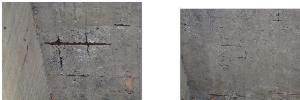
Fig. 12 Vista de la cara inferior del tablero del puente, donde se observan la falta de recubrimiento.
