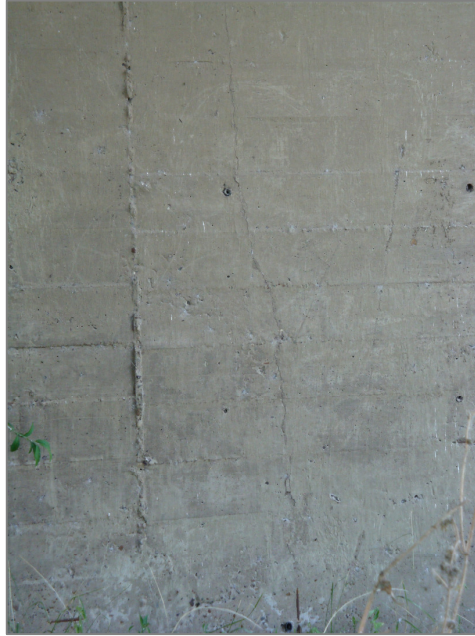
Fig. 18 Fisura longitudinal en una pila del puente.
