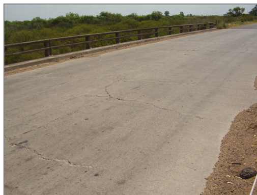
Fig. 10 Vista del tablero del puente, con signos de desprendimientos del hormigón y múltiples fisuras del tablero del puente.
