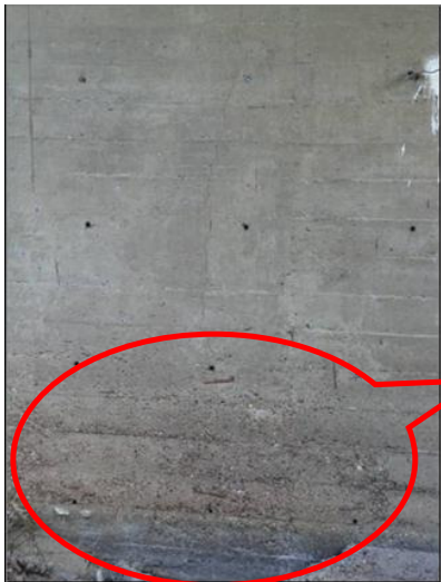
Fig. 6 Vista inferior del puente entre pilas uno y dos (a). Y Vista de fisuras en el tablero superior con procesos visibles de lixiviación. En vigas se observaron hierros afectados por corrosión (b).
