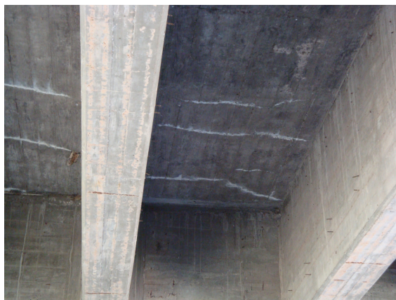
Fig. 11 Vista de la lixiviación, en la cara inferior del tablero del puente.
