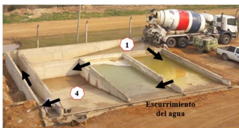
Figura 3. Sistema de piletas de sedimentación de sólidos de agua residual.
