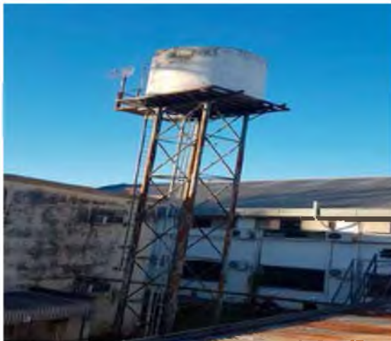
Figura 6: Tanque de almacenamiento de agua
