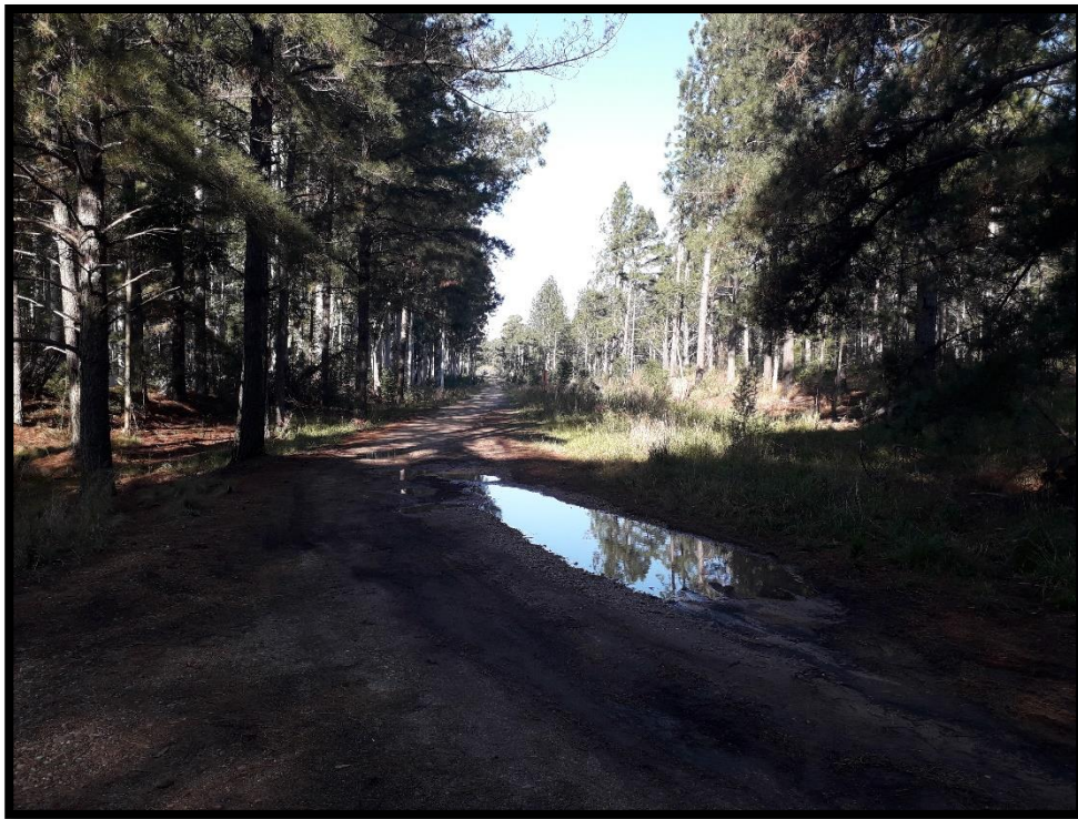
Imagen 4: Tramo dirección Oeste – Este. Baches con agua remanente
