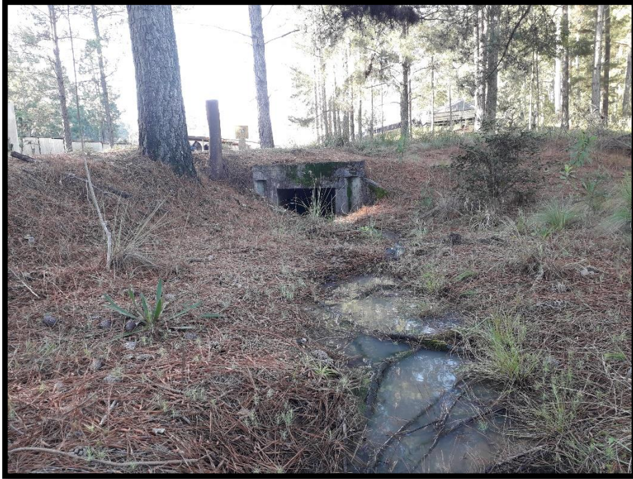
Imagen 7: Alcantarilla 1. Obstrucción de aguas arriba
