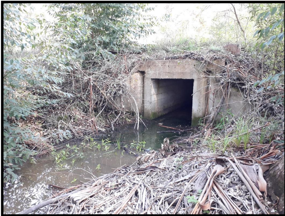
Imagen 8: Alcantarilla 2. Obstrucción de aguas abajo
