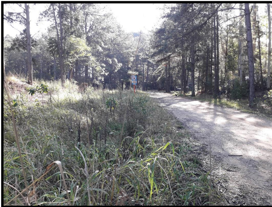
Imagen 6: Cunetas no definidas
