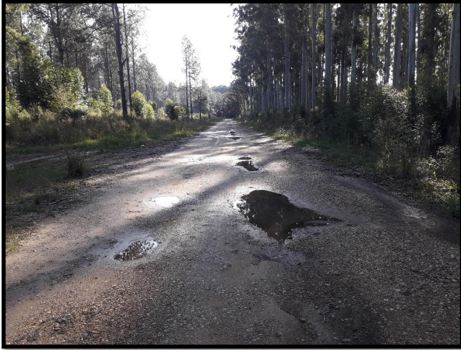
Imagen 5: Tramo dirección Este – Oeste. Ahuellamiento
