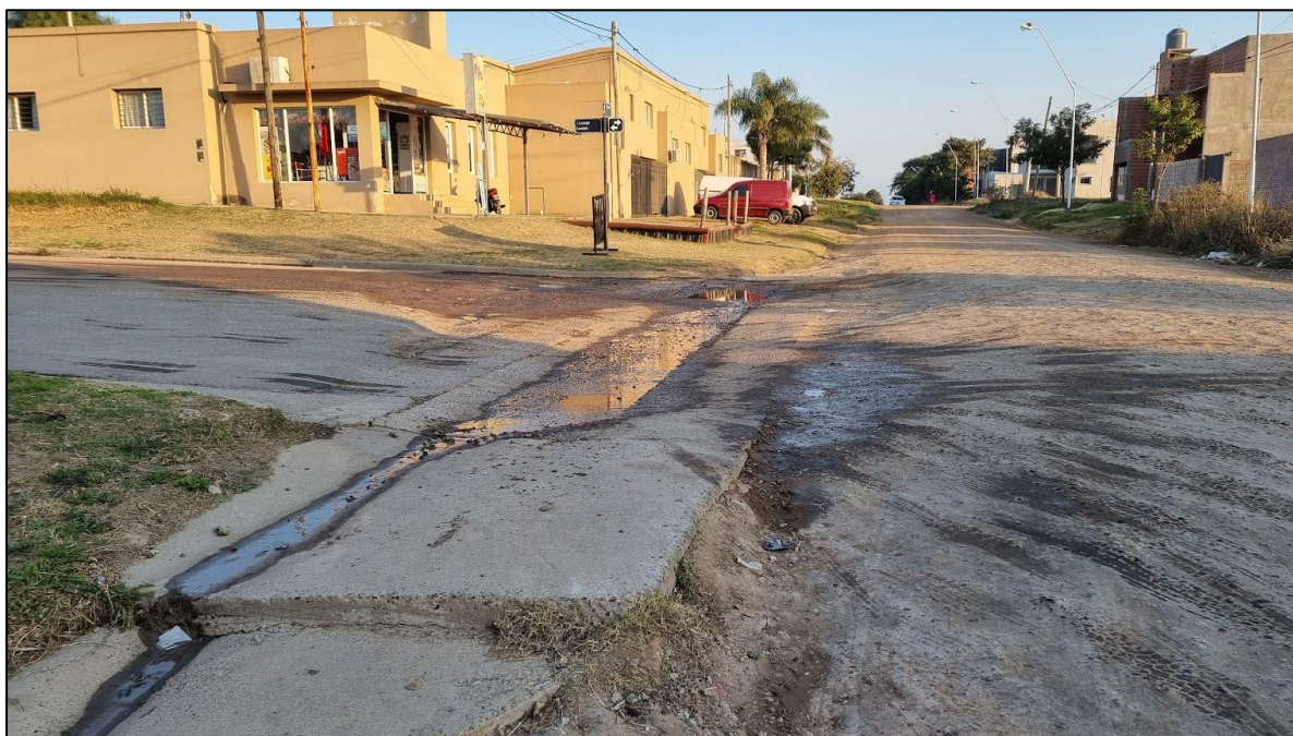
Figura 4.35 – Badén existente en esquina de Av. Ramírez y Crisólogo Larralde (lado este)
