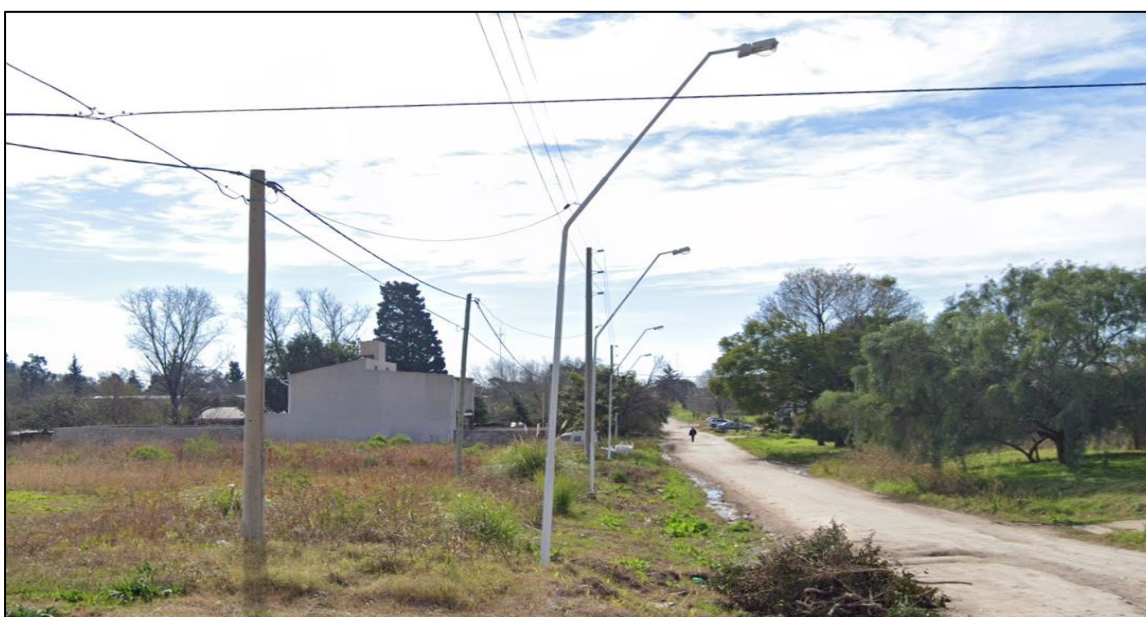
Figura 4.27 – Cableado aéreo de columnas de alumbrado público
