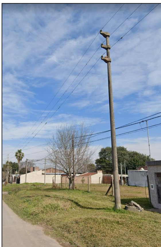
Figura 4.30 – Columna de red de media tensión
