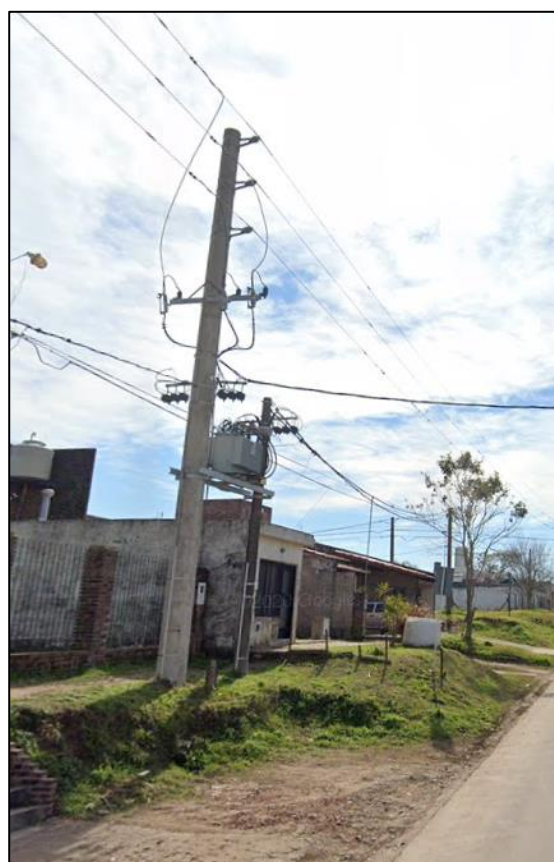
Figura 4.31 – Columna de red de media tensión y transformador
