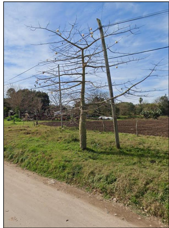
Figura 4.29 – Poste de red eléctrica
