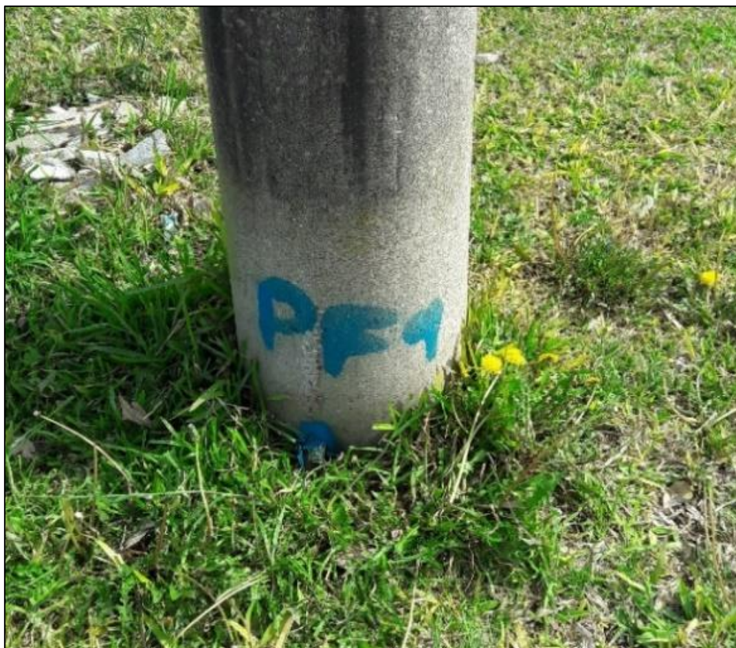
Figura 4.21 – Punto fijo en columna de media tensión
