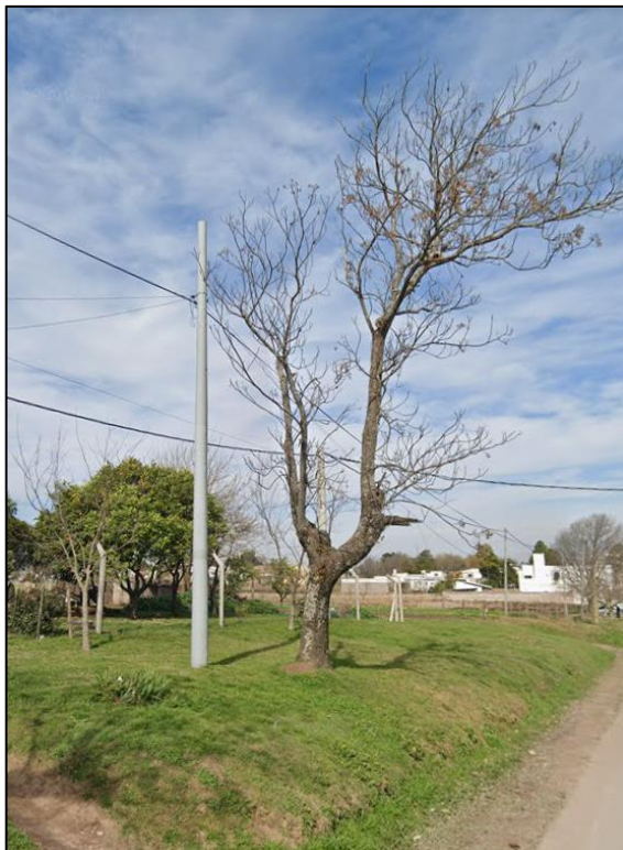
Figura 4.28 – Columna de red eléctrica
