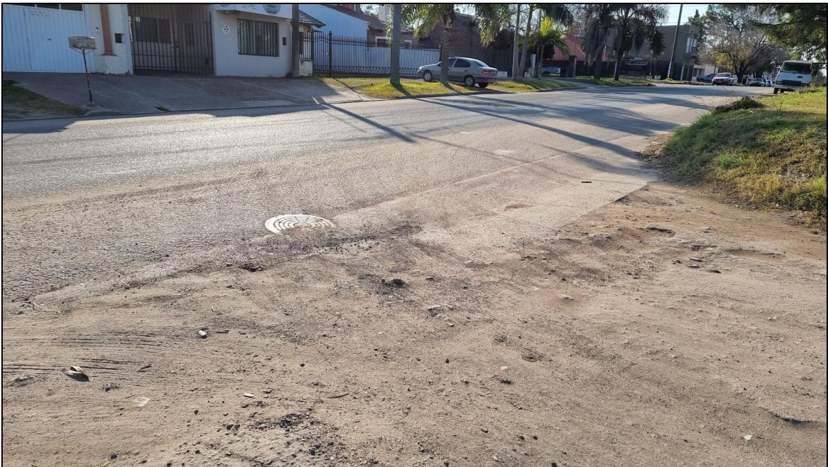
Figura 4.34 – Badén existente en esquina de Av. Ramírez y Luis Noacco
