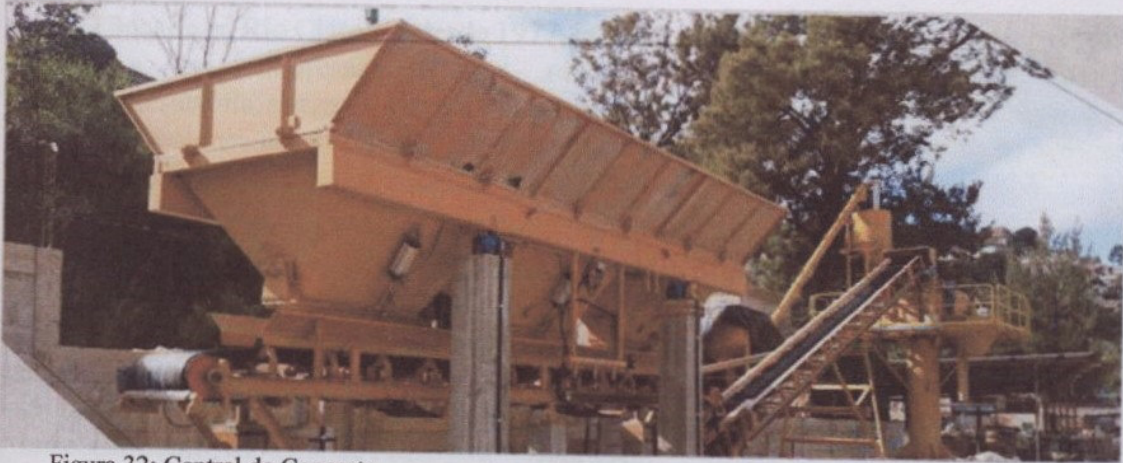
Figura 32: Central de Concreto.
