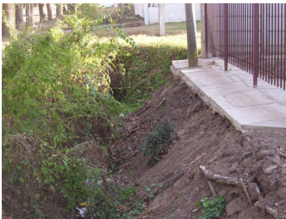
Fig. 1.7. Riesgos de desmoronamiento de construcciones
