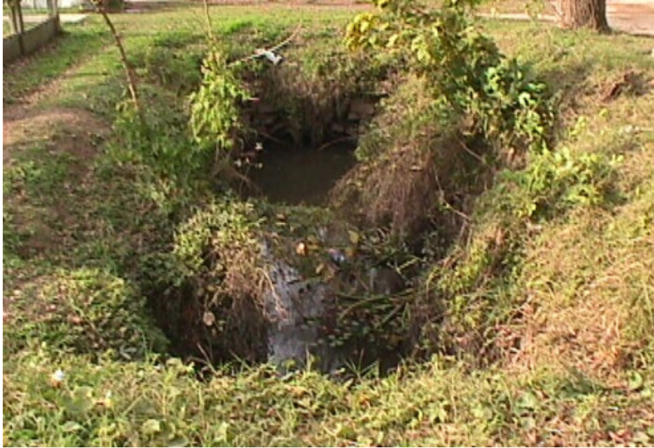
Fig. 1.4. Falta de seguridad
