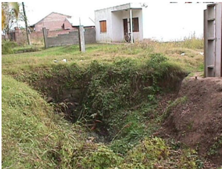
Fig. 1.8. Riesgos de desmoronamiento de construcciones
