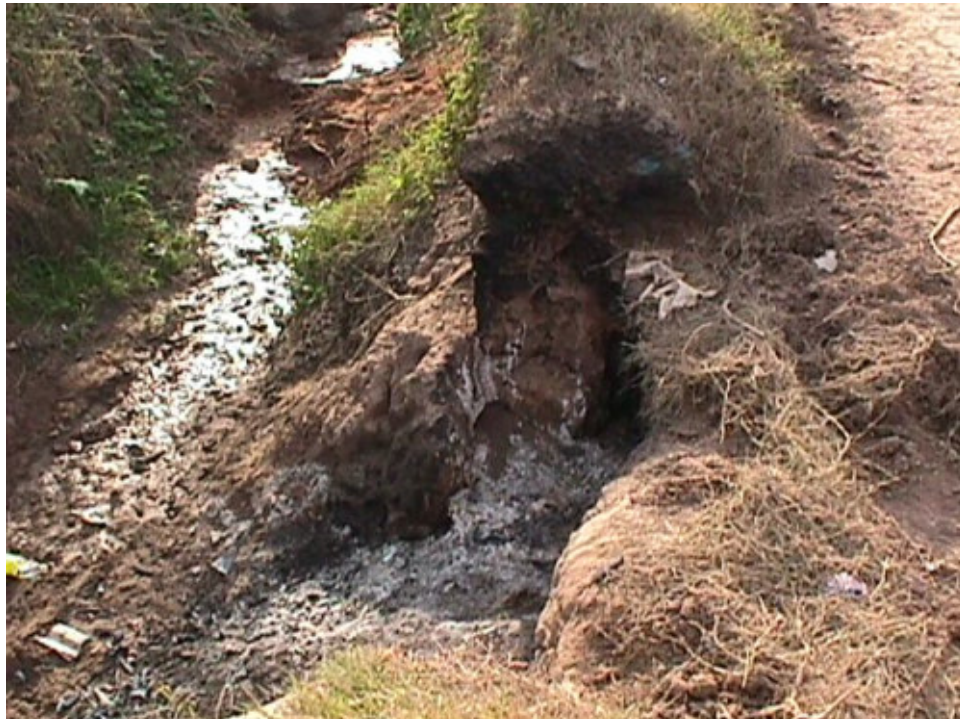
Fig. 1.5. Erosión de los taludes del canal
