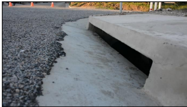
Figura 120. Boca de tormenta. Fuente:
