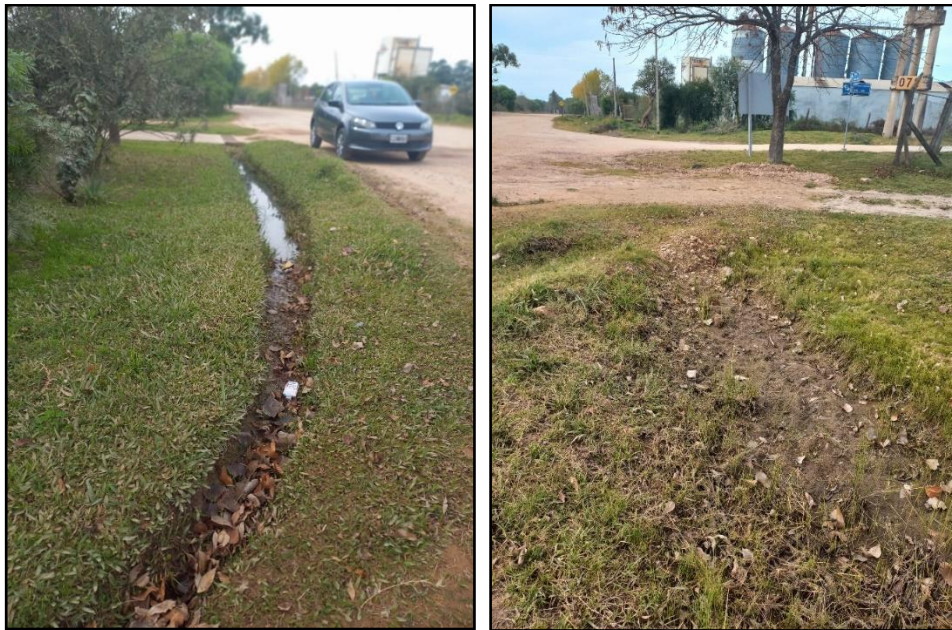
Figura 68. A la izquierda zanja hecha por los vecinos sobre Calle Pública 1165. A la derecha zanja tapada con brosa impidiendo el escurrimiento del agua. Fuente: Propia.
