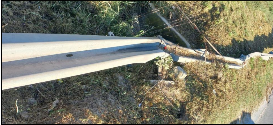
Figura 83. Guardarraíl en mal estado, sobre calle RP N°39. Fuente: Propia.
