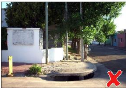
FIGURA 8 - BOCA DE TORMENTA CON DEPRESIÓN SOBRE ESQUINA CON UN TAMAÑO DE ENTRADA EXCESIVAMENTE PELIGROSO.
