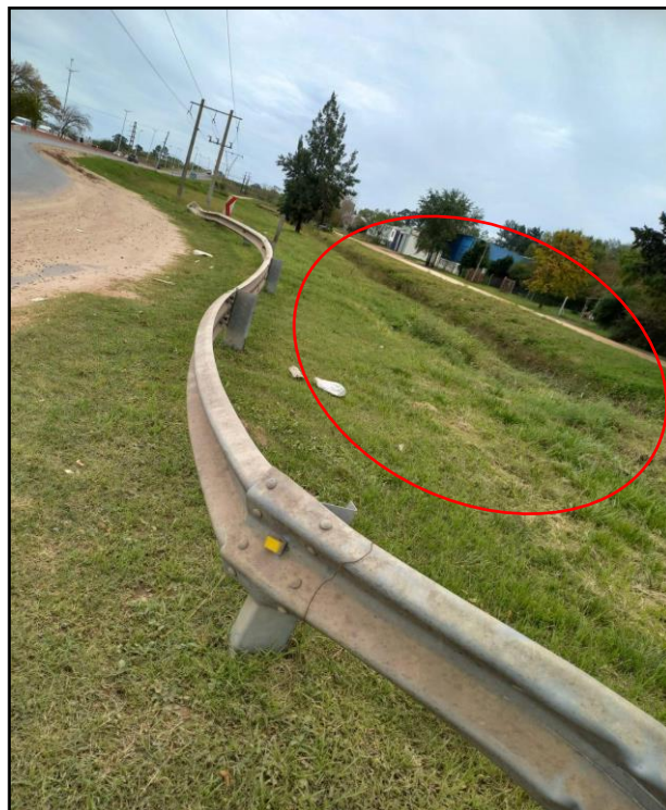
Figura 86. Canal a cielo abierto en RP N°39. Fuente: Propia.
