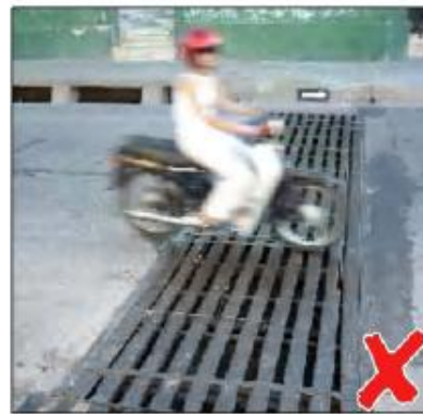
FIGURA 19 - REJA PELIGROSA POR SEPARACIÓN DE LOS BARROTES.
