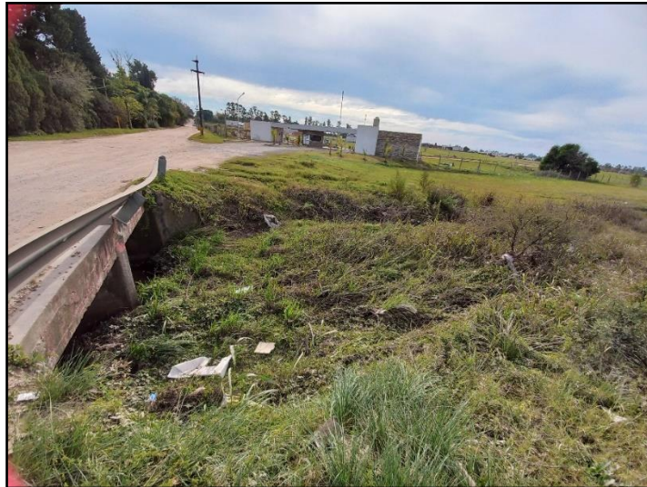
Figura 67. Alcantarillado y canal a cielo abierto intersección calle Ciudad de La Paz y Ruta Provincial N° 39. Fuente: Propia.
