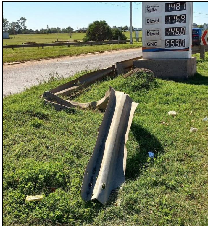
Figura 84. Guardarraíl en mal estado. Zona estación de servicio. Fuente: Propia.
