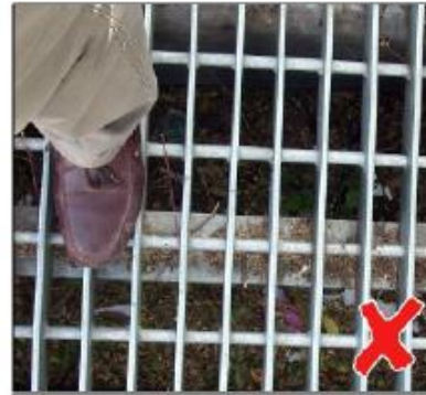
FIGURA 17 - REJA PELIGROSA POR SEPARACIÓN DE LOS BARROTES.
