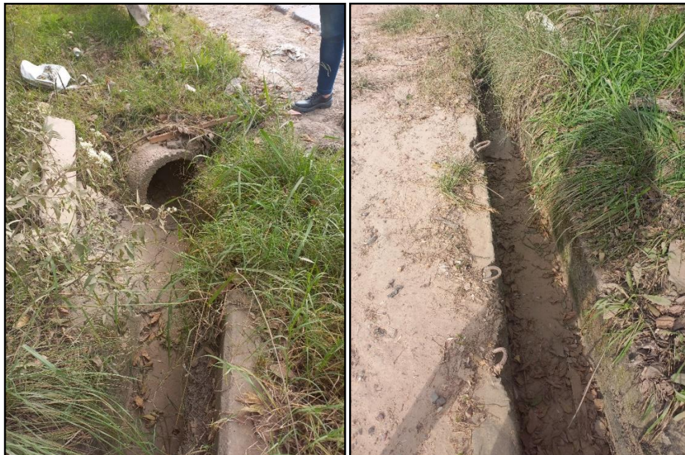
Figura 63. A la izquierda caño de hormigón de 400mm sobre ruta 42; a la derecha alcantarilla sobre ruta 42. Fuente: Propia.
