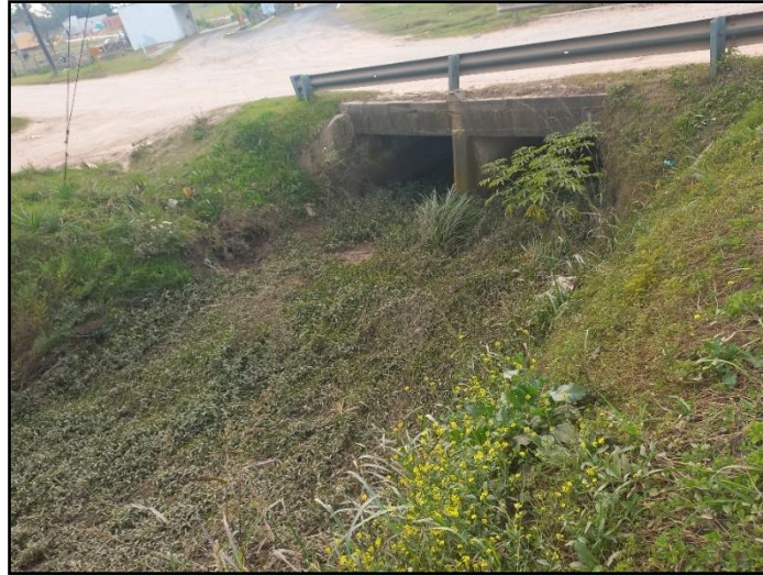
Figura 66. Alcantarillado doble con cañería de 1100mm y canal a cielo abierto. Fuente: Propia.
