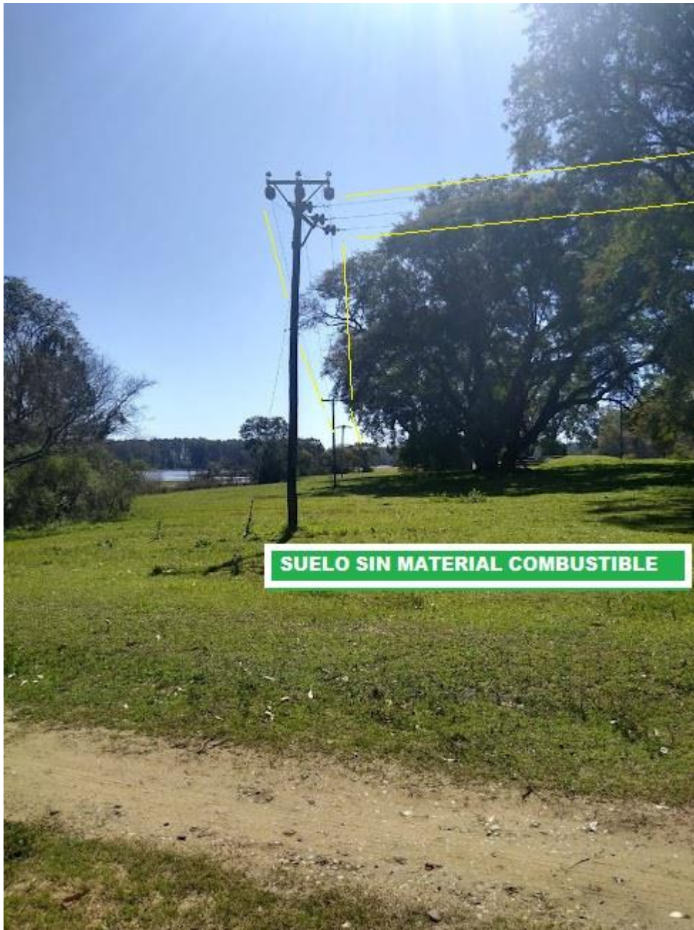
Fig. 9 Tendido eléctrico en una zona libre de material combustible.
