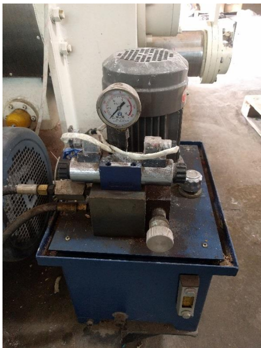
Fig. 2.12: Depósito, Motor eléctrico de la bomba hidráulica, Válvula Direccional y Manómetro.
