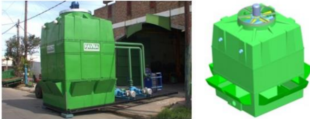
Figura 9.7 – Torre de enfriamiento
