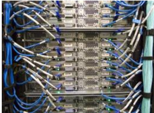
Figura 151 - Refrigeración líquida en un Data Center. Nótese las tuberías con líquido refrigerante que ingresan a cada servidor.
