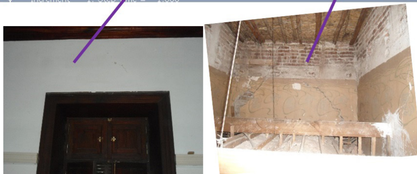
Figura 11: Daños debidos a asentamientos diferenciales de distintos sectores (Maldonado et al., 2015)
