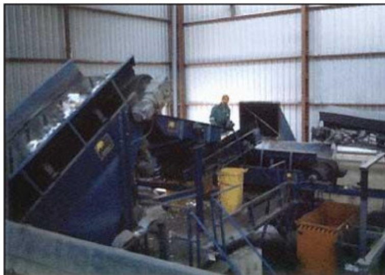
2- Operación en Planta de Tratamiento: residuos en cintas transportadoras.
